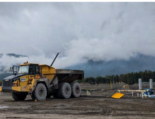
STORM AND EFFLUENT PONDS 1
